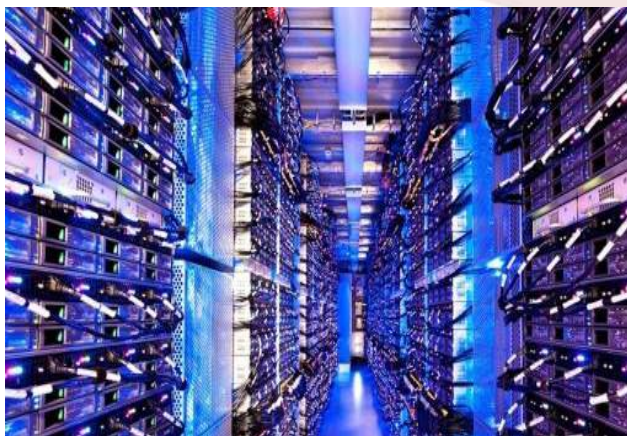
微软数据中心
